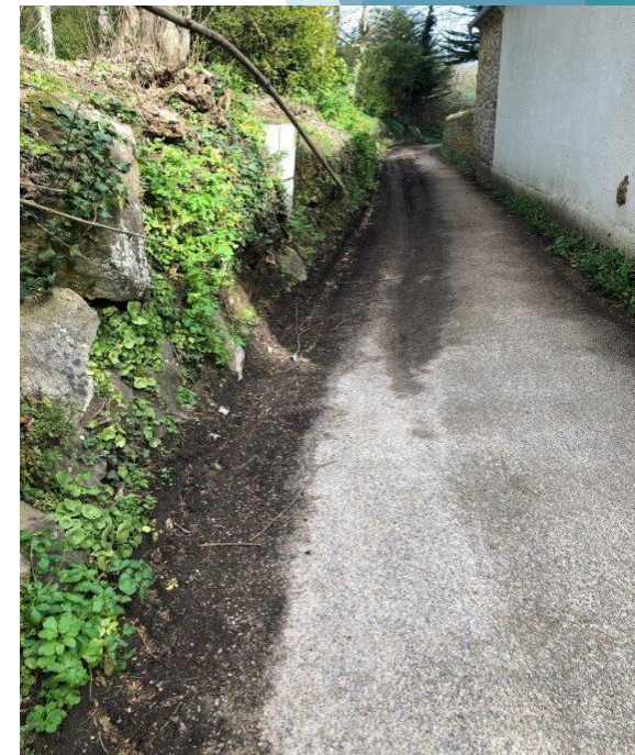
Autres sections endommagées
