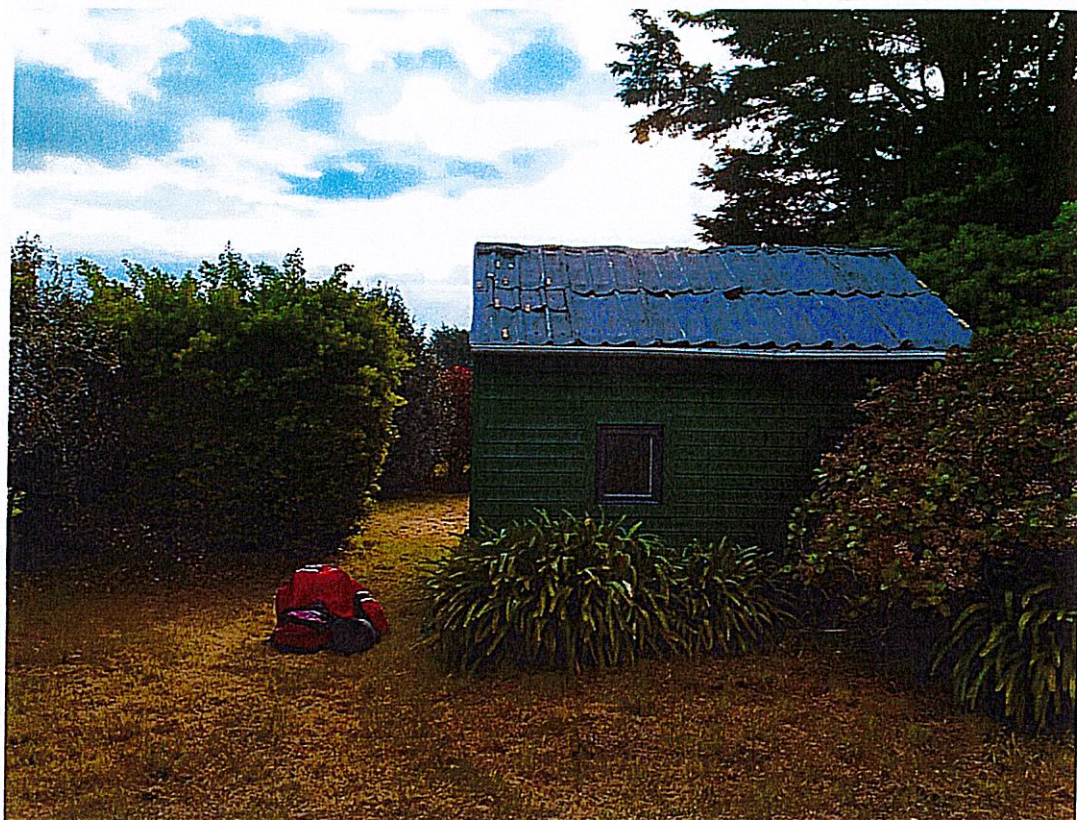
PHOTO TOIT EN MAUVAIS ETAT
